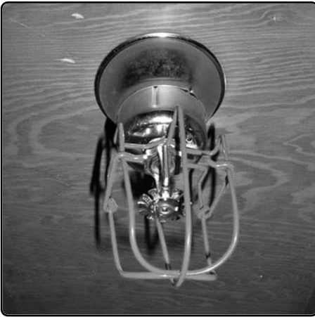
FIGURA 12. Un rociador (sprinkler) es un dispositivo para extinción de incendios, que libera una lluvia de agua sobre la zona afectada.
