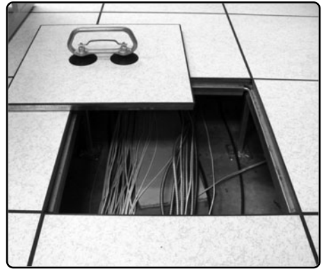
FIGURA 10. El piso técnico permite pasar cables de electricidad y datos por debajo de él.
