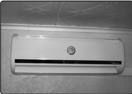
FIGURA 9. Los sistemas de acondicionamiento de aire para interiores deben ser calculados en función del volumen de la habitación, en metros cúbicos.
