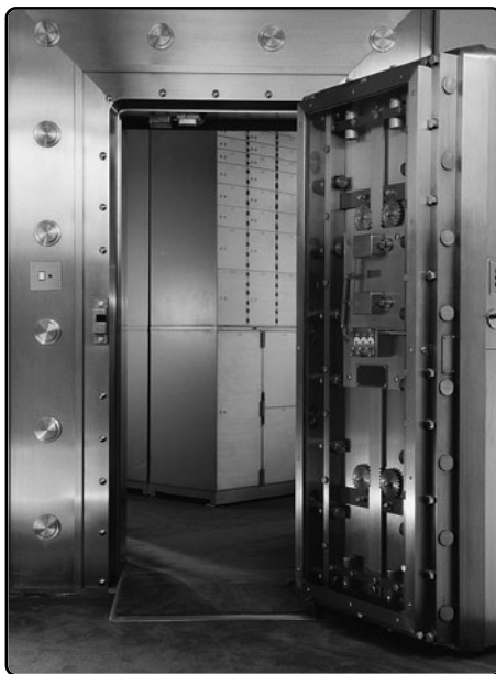
FIGURA 15. Las bóvedas de seguridad de bancos poseen puertas de acceso con el mayor nivel de seguridad disponible en el mundo.
