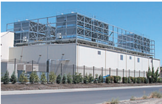
En la imagen vemos la importancia de tener un ambiente adecuado para el correcto funcionamiento de los servidores. Es este caso en particular, presentamos el sistema de refrigeración de un centro de cómputos de la empresa Google.
