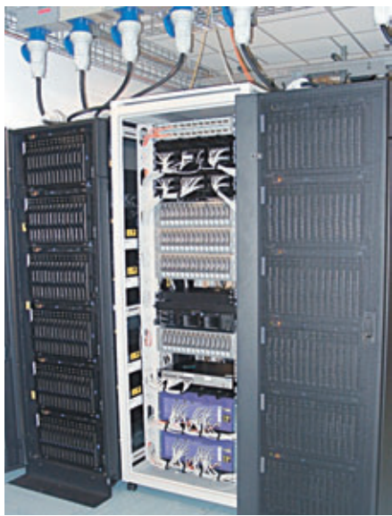
Cuando se habla de granja de servidores, se hace referencia a un conjunto de equipos apilados en la misma torre.
