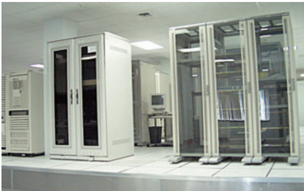
En la imagen podemos apreciar lo que se conoce como un centro de distribución de cómputos.
